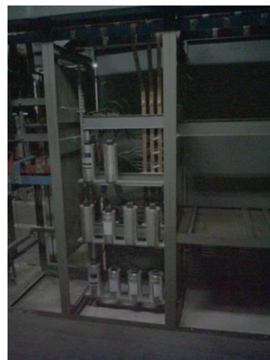
Obr. 2 Rozvodňa NN – kompenzačný rozvádzač
