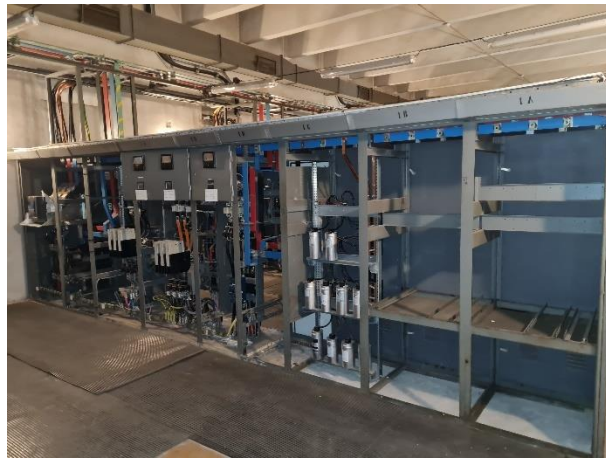
Obr. 2 Rozvodňa NN – kompenzačný rozvádzač
